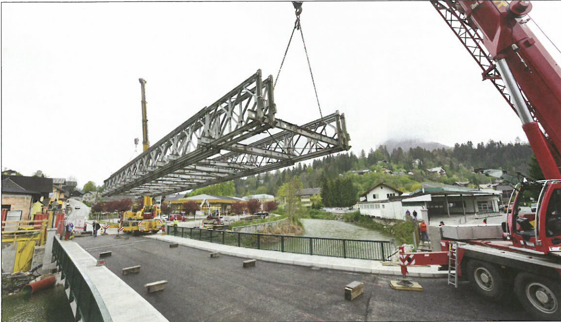
Die Behelfsbrücke wurde mittels zweier Mobilkräne abgetragen und danach von Arbeitern demontiert.
